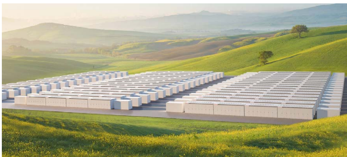
Рис. 2. Tesla Megapack строение внутри [5]
